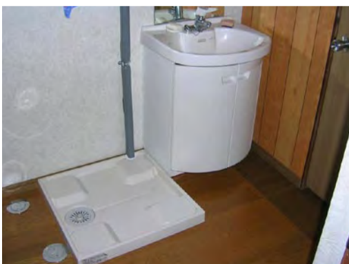
主に床、壁及び建具の内装の改修であったが、洗面化粧台及び洗濯機用パンを設置する水まわりの工事も実施 地域住宅交付金を利用し、約64万円の補助を実施済
